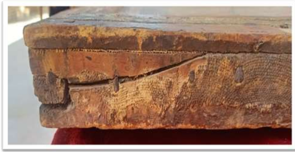
شكل رقم ( ) يوضح إنفصال في الحامل الخشبي (الباحثة).
